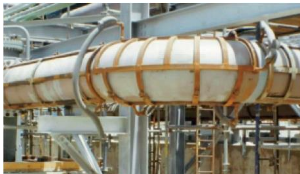
شکل (۲-۴) خط لوله مجهز به ژاکت های حرارتی Contro Trace bolt-on در ترمینال انتقال گوگرد مذاب
