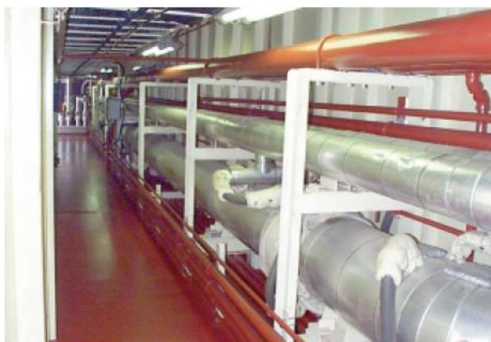
شکل (۴-۴) خط لوله عایق بندی شده انتقال گوگرد مذاب در کشتی Sulphur Enterprise مجهز به سیستم Contro Trace bolt-on
